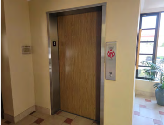
35 Elevator Cab Door
